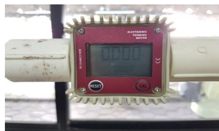
Figura 4. Medidor de fluxo.
