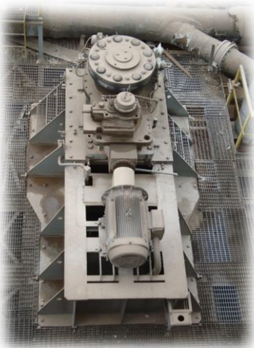
Figura 6. Motor Assíncrono e Redutor. Fonte:[10]
