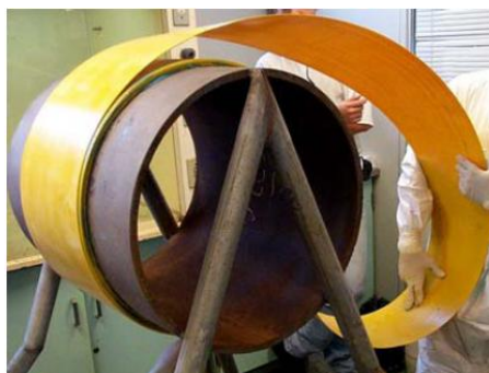
Figura 1 - Exemplo de aplicação de material compósito em um segmento de duto de aço. Fonte: Fujiyama et al. , 2003.
