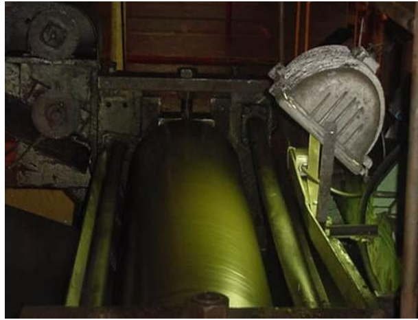
Fig. 2 – Fotografia do sistema de guiagem , para guiar as tiras e proteger os rolos
